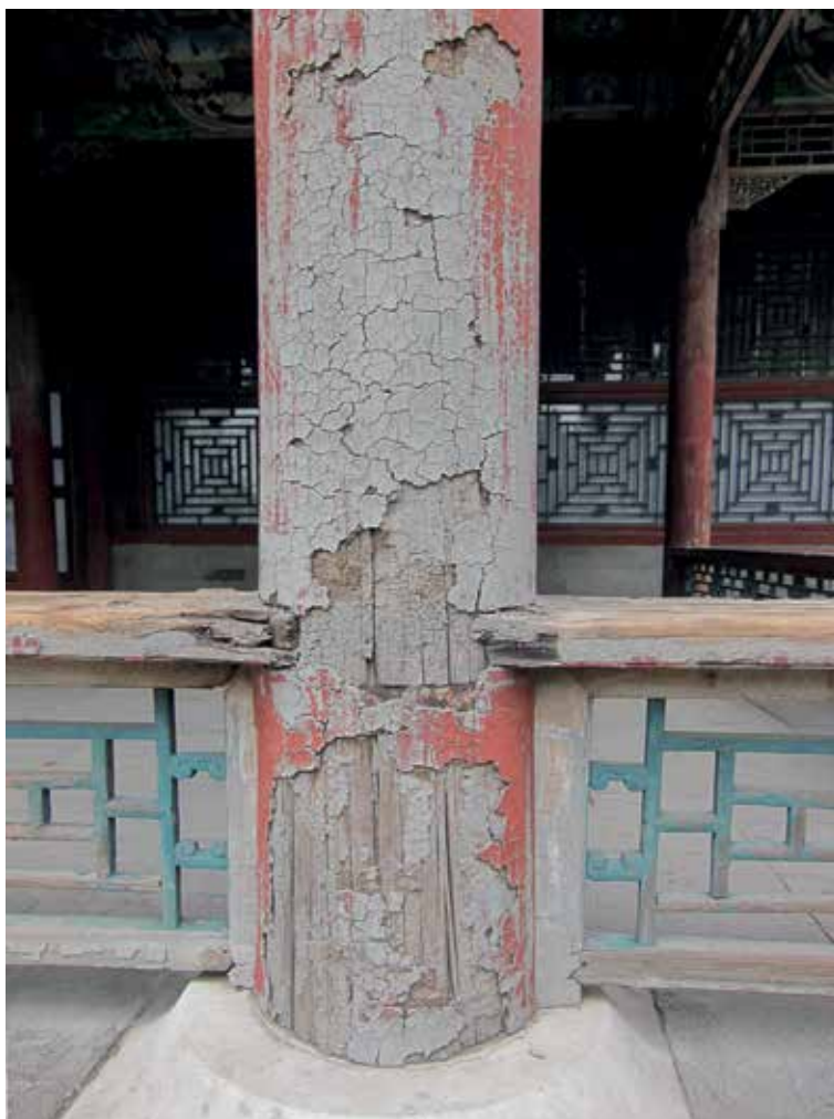
85. Peking, Letní palác, oprýskaný nátěr sloupu jednoho z dřevěných pavilonů. ▪ Beijing, Summer Palace, a paint-peeled column of one of the wooden pavilions.
